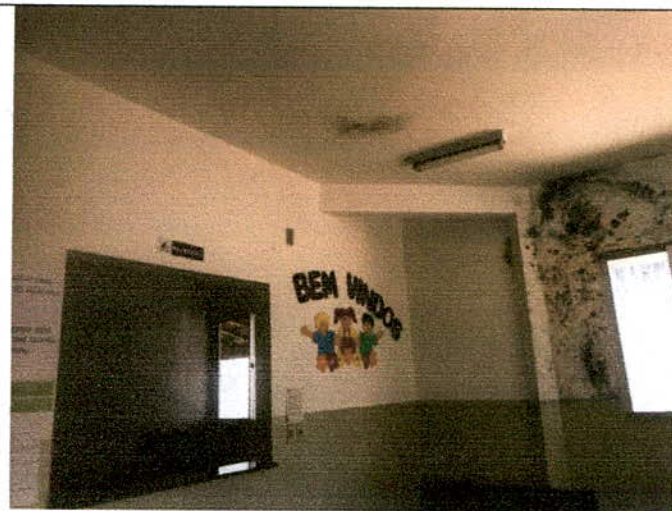
FIGURA 06- Sala de espera com infiltração
